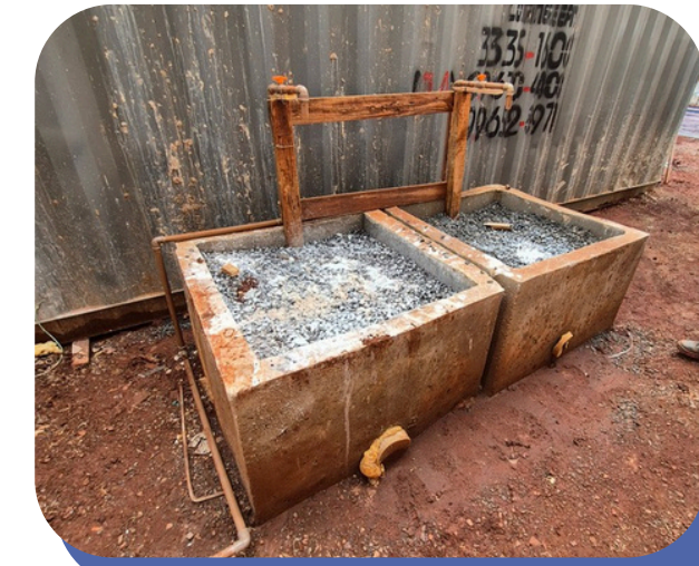
▶ Bacia de coleta e decantação de lavagem de pincéis
