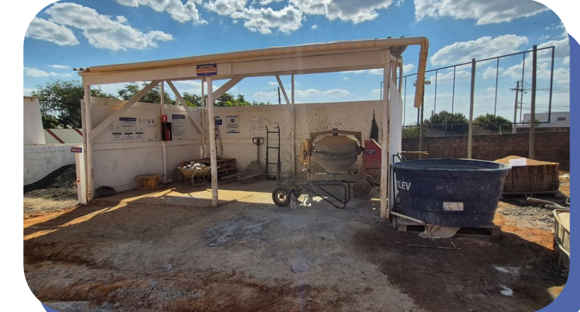
▶ Captação de água pluvial
